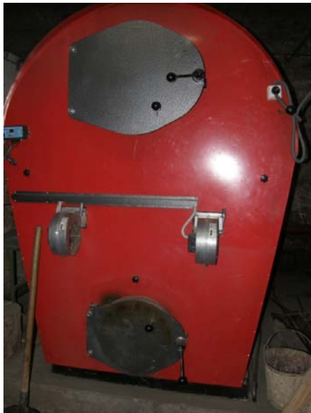
Рисунок 8 – Піролізний котел, призначений для спалювання твердого палива та палива з біомаси в котельні Путильської ЗОШ І-ІІІ ступенів
